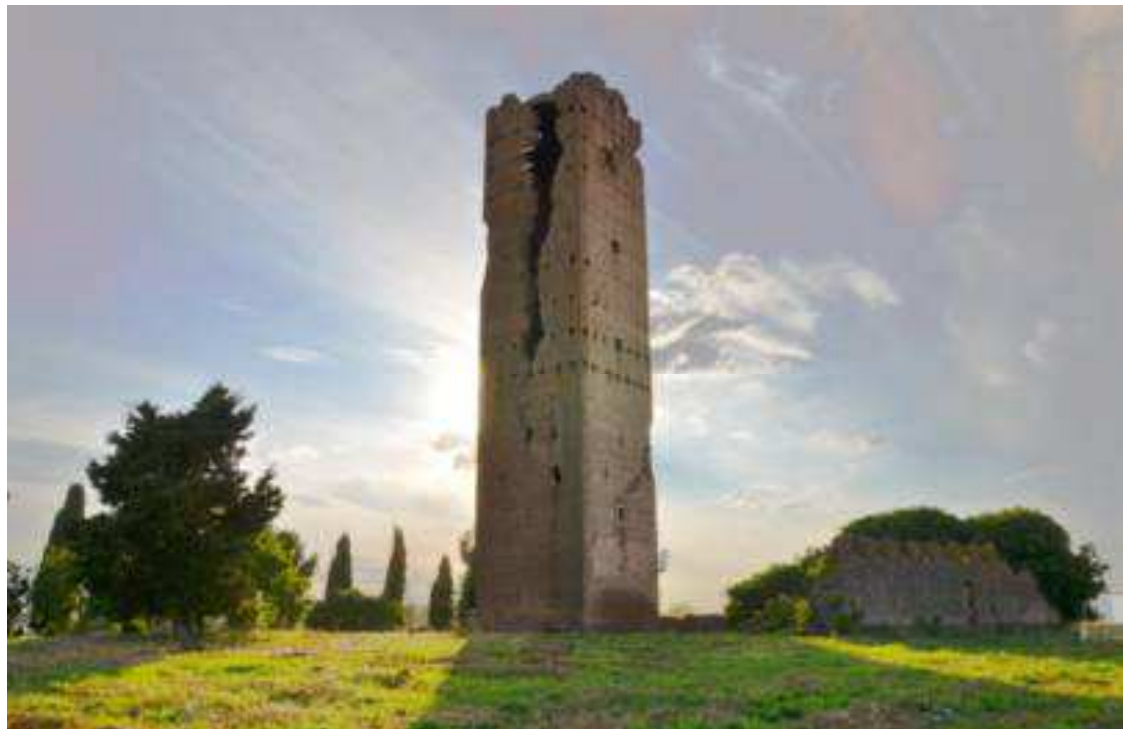
Fig. 45 Torre Maggiore (num. 56) vista da via della Chimica. Si nota il poderoso squarcio sul lato Sud dell’edificio turrato e i lacerti della struttura muraria merlata del castrum .
