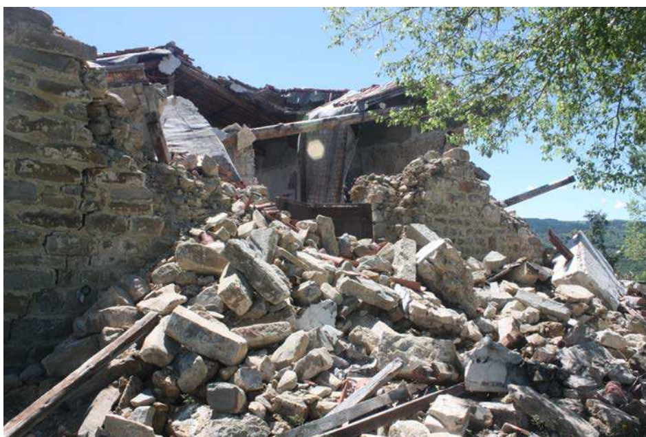
Dettaglio del crollo dell'aula.
