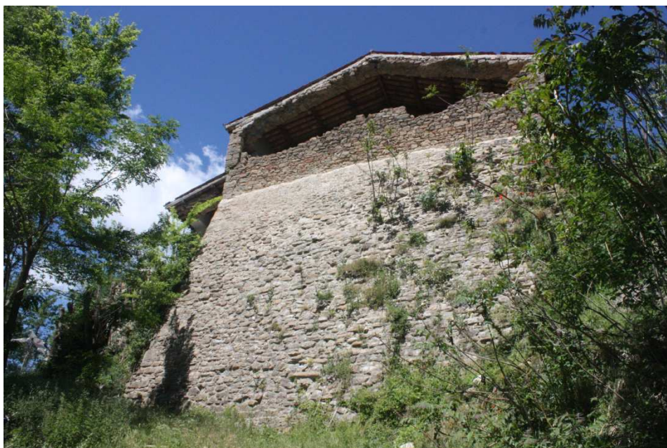
La zona posteriore con la grande lacuna nella muratura causata dalle scosse.
