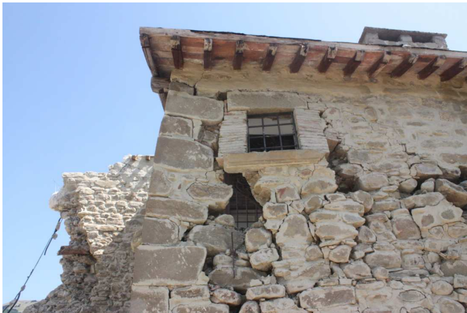
L'instabilità dello spigolo della canonica.
