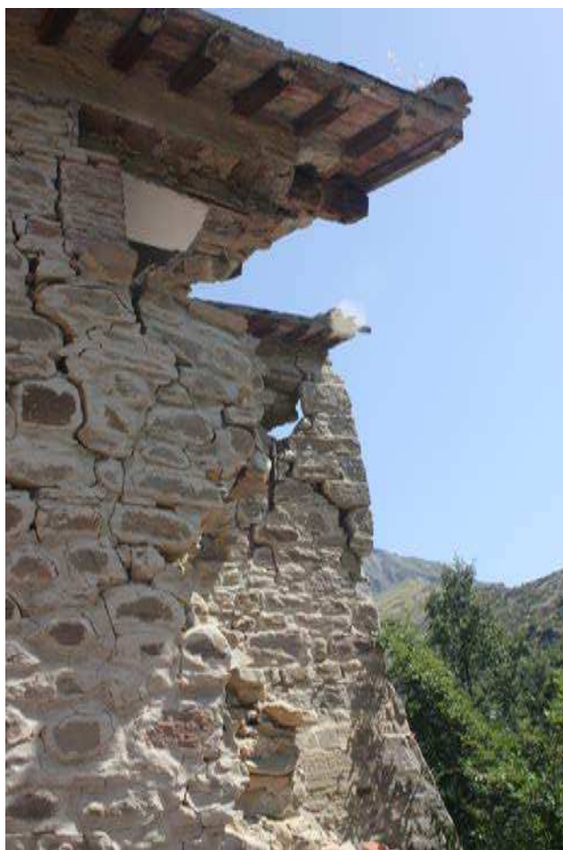
Lesioni nella muratura della canonica verso la parte posteriore.
