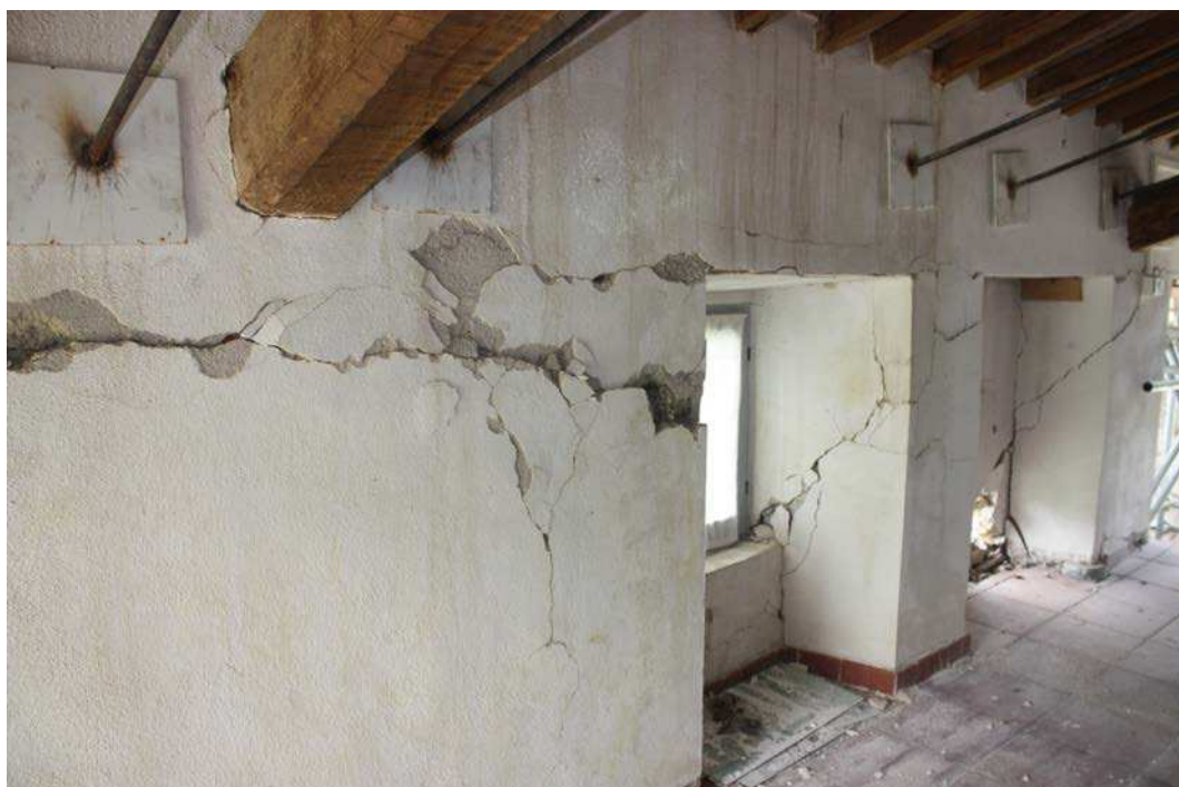
Particolare delle lesioni all'interno della canonica.
