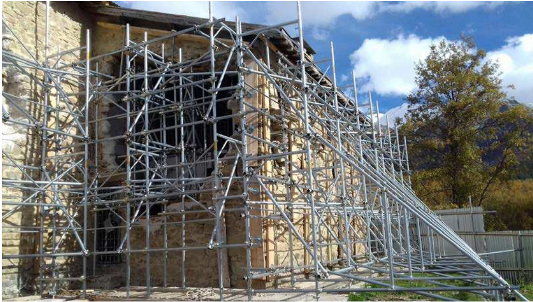
La struttura in tubo e giunto realizzata a sostegno della canonica.
