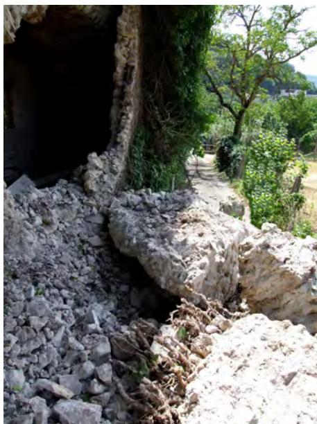
Fig. 2. Il crollo del 2008, in vista gli apparati radicali che hanno determinato il distacco della muratura.
