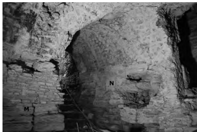
Fig. 4. Muri in blocchi di testina (M-N), sormontati dall'antica volta in conglomerato cementizio.
