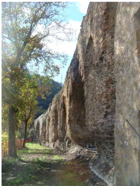
Fig. 10. Erosione delle murature al piede dei piloni.
