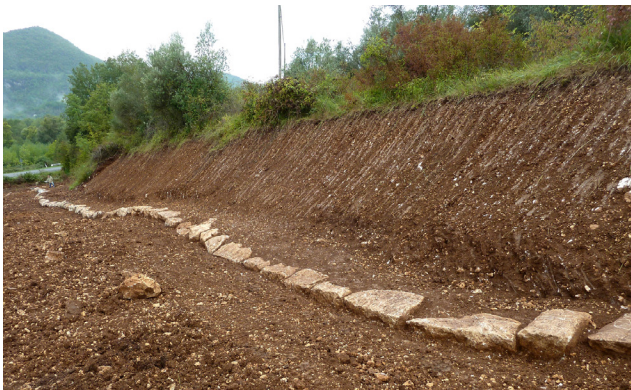
Fig. 1. Roviano, via Tiburtina Valeria, km 56: sostruzione della via Valeria (vista da quota superiore).
